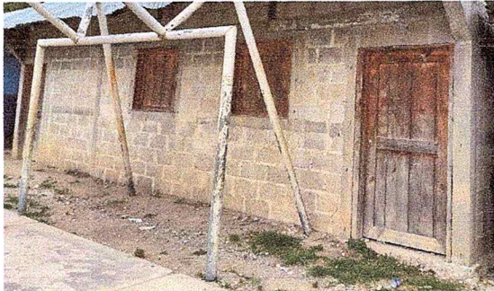
Foto 13: Se realizará el repello y cernido de paredes para una mejor visibilidad, sobre todo para que puedan pintarse las paredes que se encuentran dañadas.
