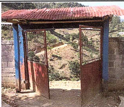
Foto 9: Mantenimiento del portón que se encuentra en la entrada principal de la Escuela, debido a las malas condiciones en las que se encuentra y la mala presentación que da al Establecimiento.
